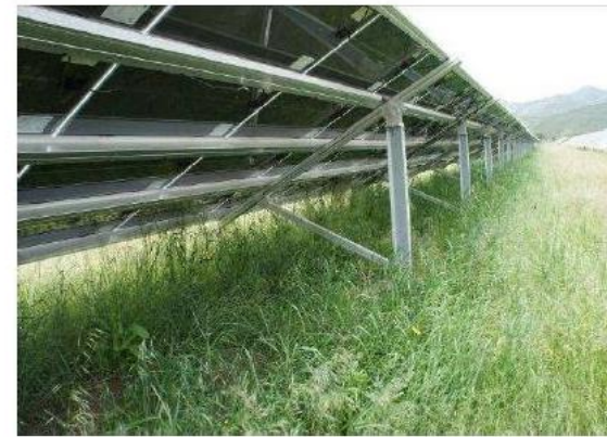
Parc solaire de Rapale (Corse),
