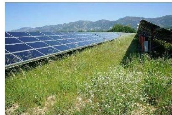
Parc solaire de Rapale (Corse),
