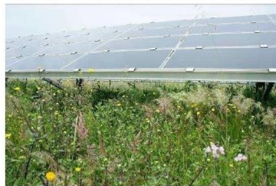
Parc solaire de Rapale (Corse),
